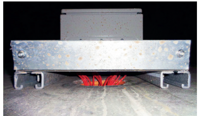
Рис. 16. Шкаф с мультиплексорами, установленный над закладной деталью на стене КФ
