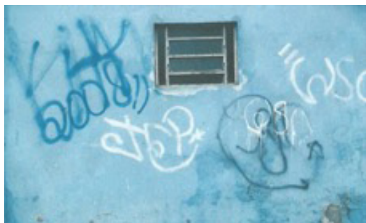
Figura 1 – Detalhe de pichações na fachada da casa nº 63 da Rua Santos, em Joinville
