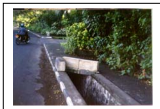
Gb.7: Trotoar yang menutupi got terputus tanpa tanda yang jelas
