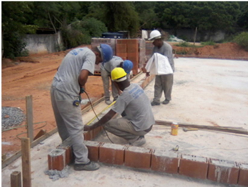
Figura 3. Execução da obra com alvenaria estrutural: Execução da primeira e segunda fiada.
