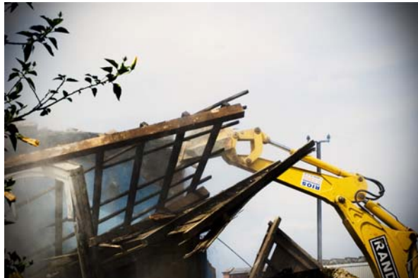
Foto 02: Destruição do madeiramento do telhado.
