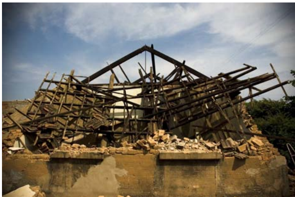
Foto 03: Escombros do madeiramento do telhado.
