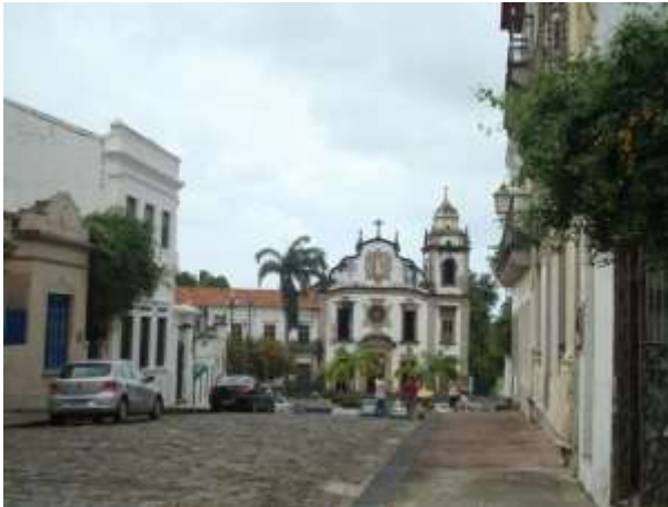
FIGURA 8: Mosteiro de São Bento em Olinda na ZEPC1. Patrimônio da Humanidade. Nota-se a falta de conservação da fachada. Fonte: Levantamento próprio, 2009.
