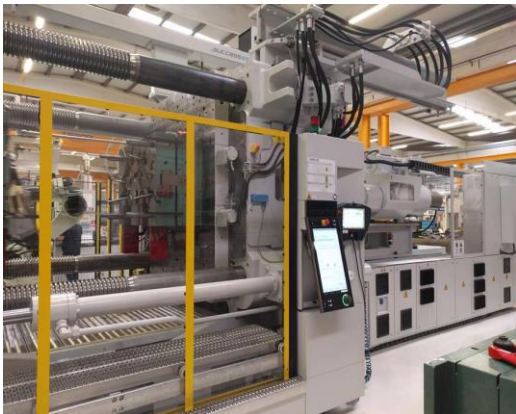
Figura 3.15 - Máquina de Injeção
