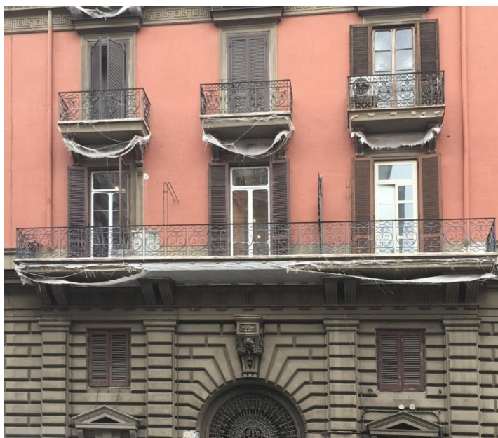
Figura 3: Un edificio ottocentesco del centro storico partenopeo deturpato dalla presenza di reti protettive maldestramente fissate all'intradosso dei balconi
