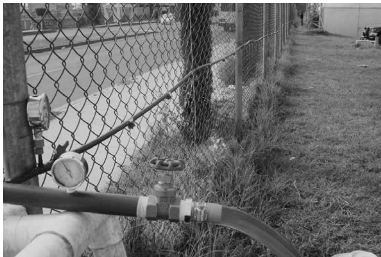
Figura 4. Control de presión en la entrada del lateral.
