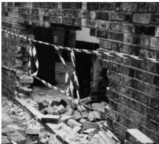
Figura 12. Falla en muro de mampostería en Cambridge, Reino Unido, diciembre de 2001. Fuente: Kelman (2002).
