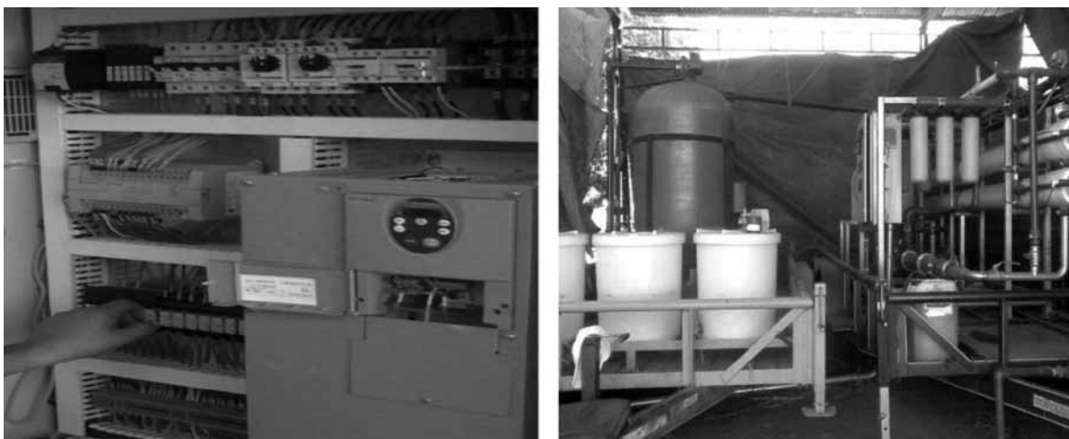
Figura 5. Planta desaladora de 100 m 3 /d, ubicada en un campo agrícola de Sonora, México. Lado izquierdo, PLC (Allen Bradley). Lado derecho, pretratamiento, filtros y membranas.
