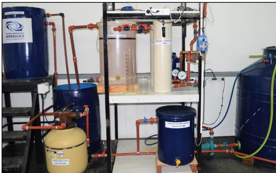
Figura 6.24. Planta para el tratamiento de 4 m 3 /día de agua instalada en la Facultad.
