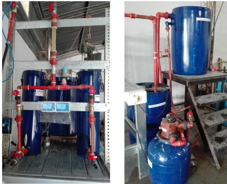
Figura 7.18. Planta para el tratamiento de 4 m 3 /día instalada en la cooperativa de Verónica.
