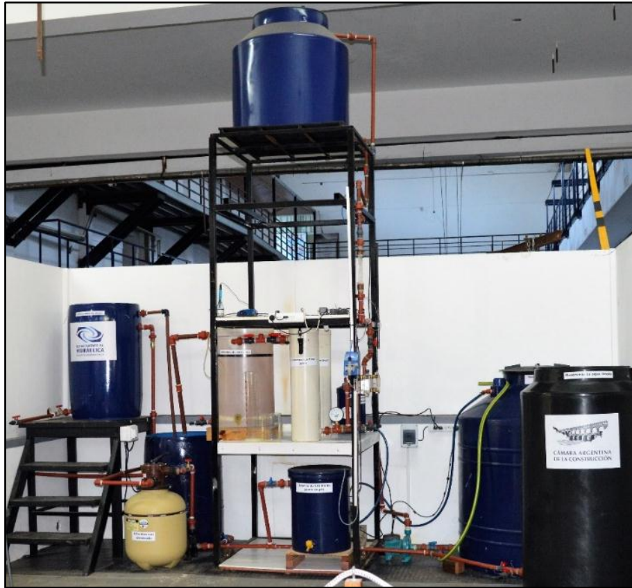
Figura 6.23. Planta para el tratamiento de 4 m 3 /día de agua instalada en la Facultad.
