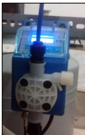
Figura 2.5. Bomba para la regulación y control de pH marca Acquatron.
