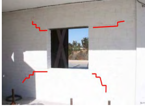
FIGURE 1.4: Apparition des fissures après le scénario S3 [Moaveni 2011]
