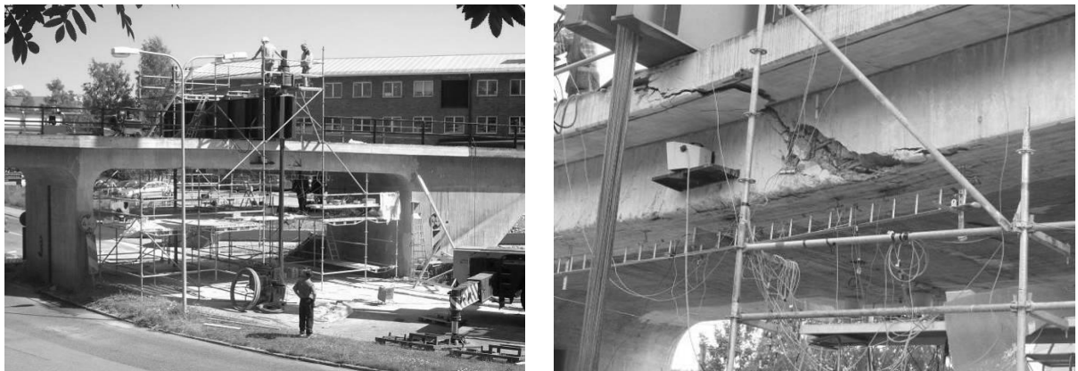
FIGURE 2.29: Identification des déformées modales : (a) pont Övik avant l'endommagement, (b) endommagement de la poutre latérale sud
