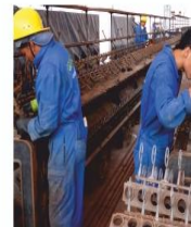
Imagen de mantenimiento de
