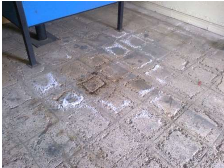
Piso en mal estado.
