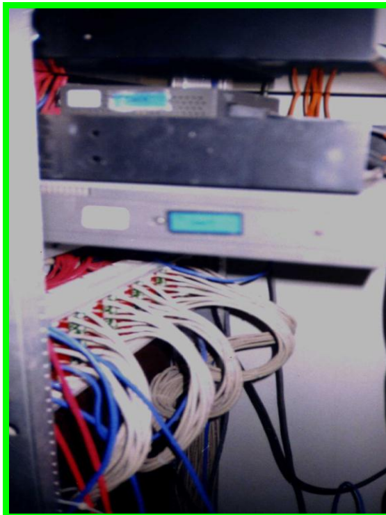
Cableado estructurado, vista posterior.
