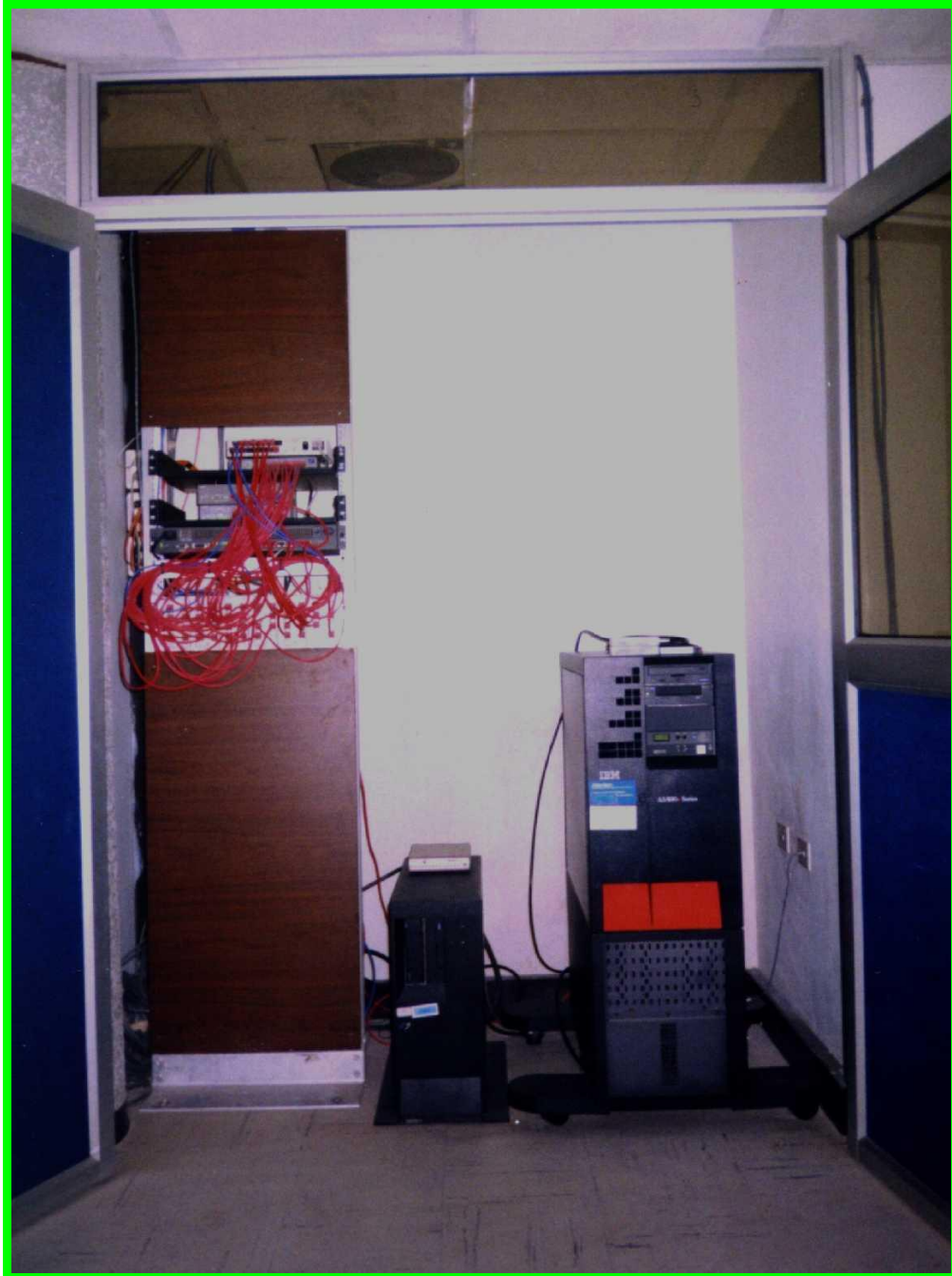
Fotografía de la Estructura física de la Red.
