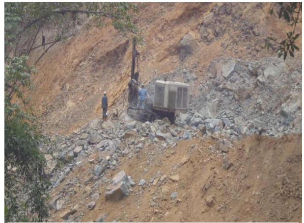
Fotografía 16: Ampliación de camino, impacto negativo generado en el río
