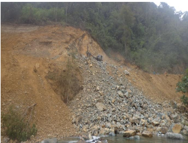
Fotografía 17: Escombros arrojados hacia el río
