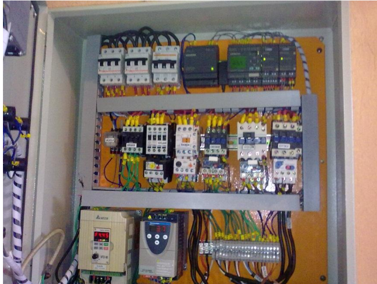
FIGURA 19. Tablero de Control
