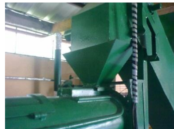
b) Tolva instalada
