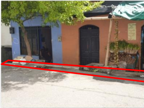
Figura 25. Ausencia de andenes, las viviendas se encuentran a otro nivel de la vía
