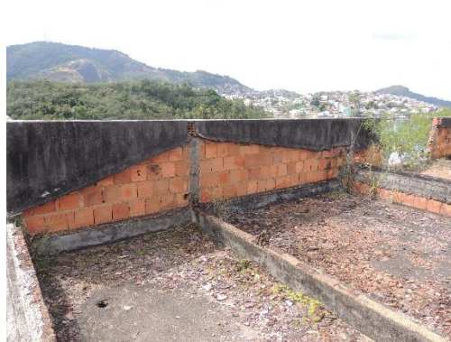
Marcas de um telhado que já não existe mais.
