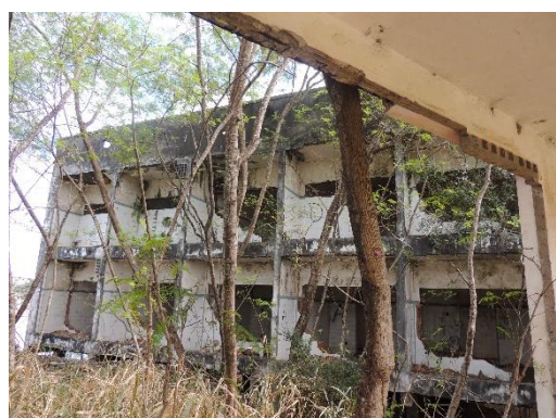
Paredes quebradas e pichadas.
