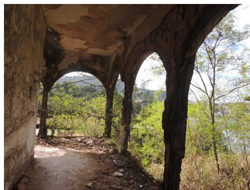
Ferragens expostas nos arcos da varanda.
