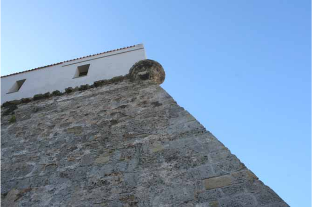
Figura 6: residui della garitta sul lato nord del bastione di Santa Croce.
