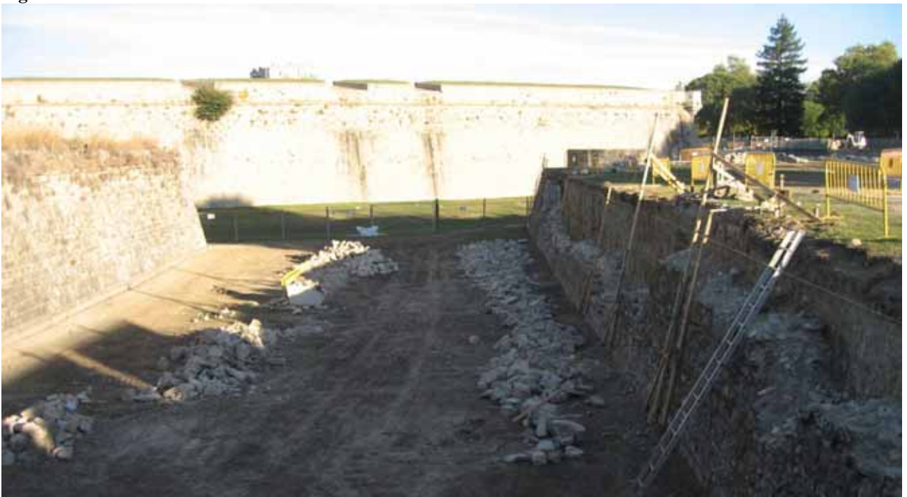
Figura 44: lavori di restauro dei rivellini - rifacimento della camicia di rivestimento del terrapieno.
