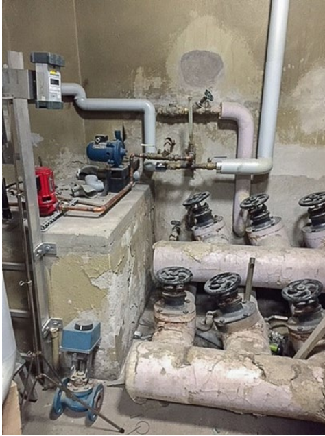
Kuva 1. Lämmönjakuhuoneen purettavat asbestia sisältävät massaeristeputket. Kuvassa vasemmalla DataRam-hiukkasmittari telineessä hengityskorkeudella.
