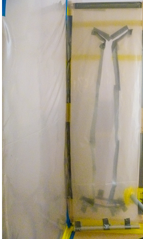
Kuva 3. Imurin letku työntekijän puhdistautumista varten johdettu osastoivan rakenteen läpi sulkutunnelin sisimpään osaan.
