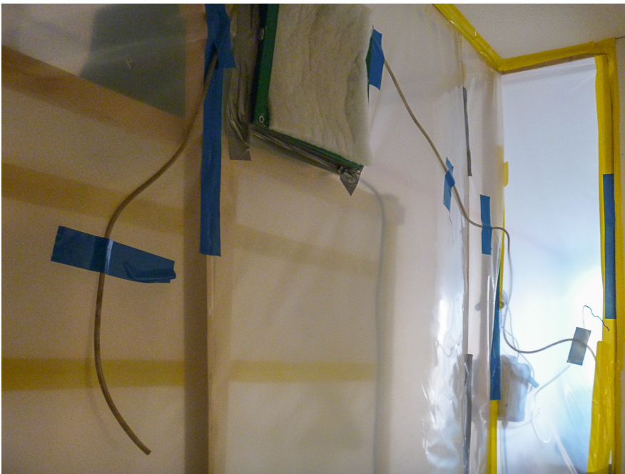
Kuva 1. Osastoinnin sisäpuoli. Alipaineistaja sulkutunnelin katolla.
