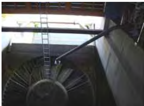
Vue du tube d'injection relié à la pièce métallique installée sur le distributeur de la VLH - © Ecogea
