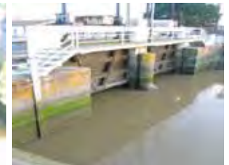
Vannes de régulation du niveau d'eau en amont - © P. Baran
