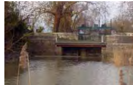
Vue aval de l'ouvrage de Charras (portes à flot fermées à pleine mer) - © P. Baran
