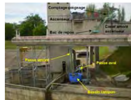
Passé à anguille de l'usine de Golfech (Garonne). Vue générale. © F. Travade EDF
