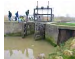
Portes à flots et clapets ouverts lors du jusant - © P. Baran
