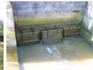
Clapets de régulation - © P. Baran
