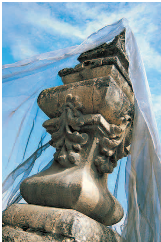
5. Fragmentación/fisuraciones. Pináculo de la Real Chancillería de Granada. Imagen: Jesús Espinosa (IAPH)
