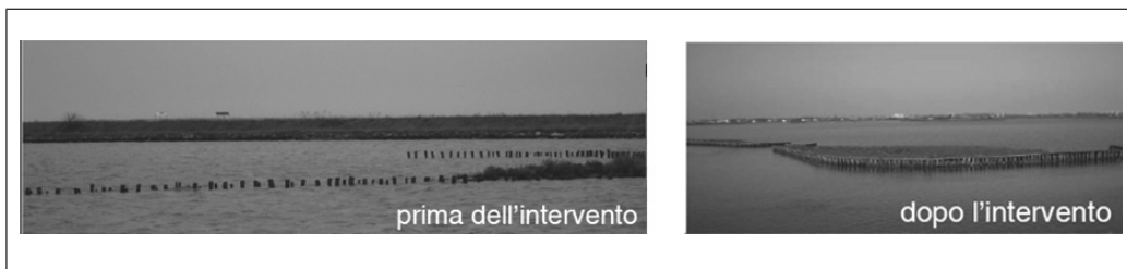
Riscavo del tratto terminale del canale sub-lagunare Fattibello e del canale Ungola (Azione C1) - LIFE09/NAT/IT/110. Fonte: Progetto LIFE09/NAT/IT/110
