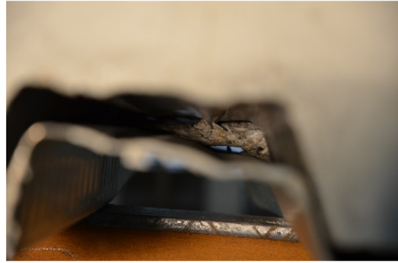
Abb. 4-39: Betonausbruch an Sicke im Längsschubbereich, Serie 2-03, ca. 95 mm vertikale Verformung), aus [69]
