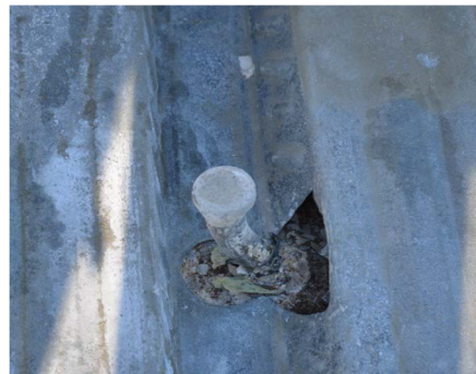
Abb. 4-15: Zerstörtes Profilblech aufgrund Durchstanzversagen nach Entfernen des Betons, aus [2]
