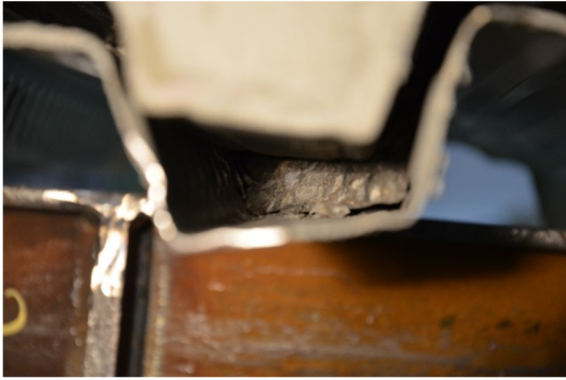
Abb. 4-38: Betonausbruch an Sicke unterhalb der Lasteinleitung, Serie 2-03, ca. 95 mm vertikale Verformung), aus [69]
