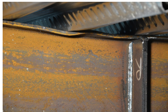
Abb. 4-45: Detail: Örtliches Ausbeulen des Oberflansches in Bereich der Lasteinleitung, aus [69]
