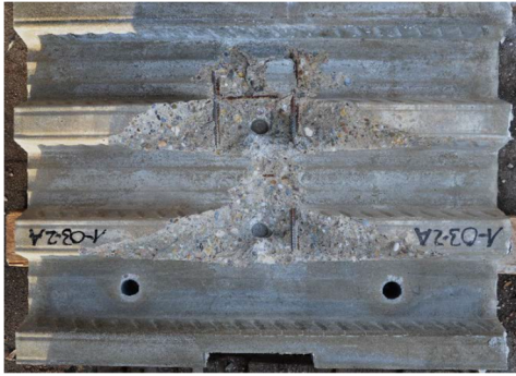
Abb. 4-16: Gerippte Oberfläche des Betongurtes mit Betonausbrüchen, aus [2]
