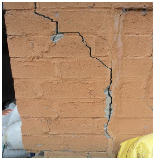
Figura 44. Fotografía de una vivienda con las paredes agrietadas – Vereda Naranjal
