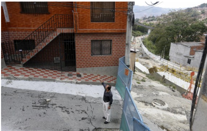
Figura 36. Daños en la estructura de las viviendas en el barrio Alejandro Echavarría – Sector San Luis (1)
