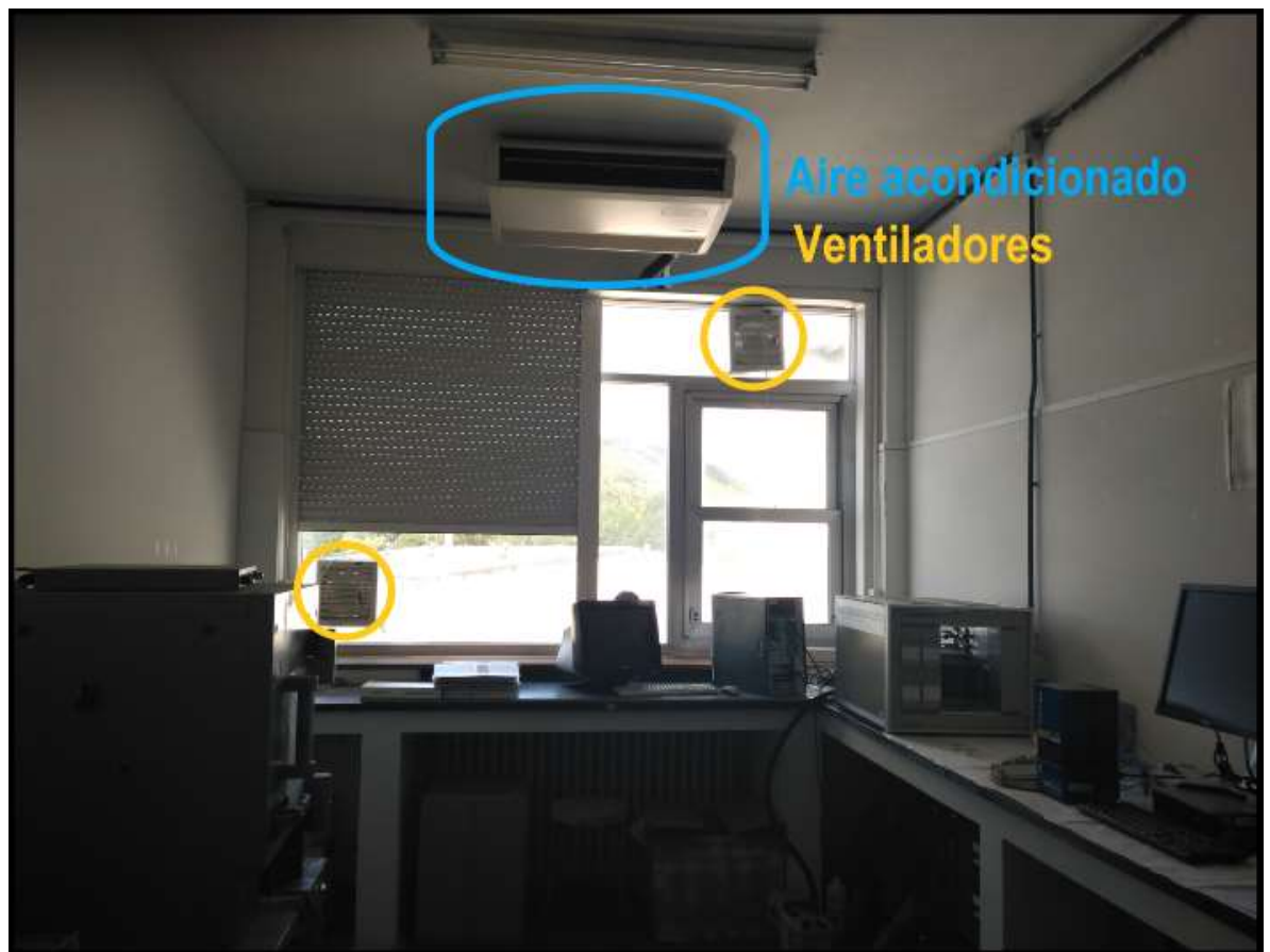
Figura 8-7 Sala de medición con todos los sistemas incorporados.
