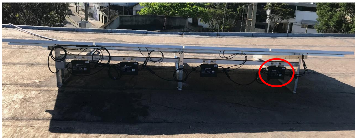
Figura 22 - Microinversores da APsystem instalados
