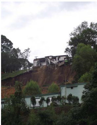
Figura 4 . Representan el proceso erosivo en las cuencas urbanas, sector arenillo 2011. Fotografía del autor.
