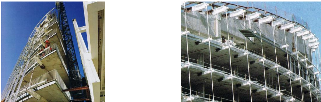
Fig. 3.59 Detalle de tirantes exteriores, tetones exteriores de cuelgue de forjados y tetones superiores de cuelgue exterior.
