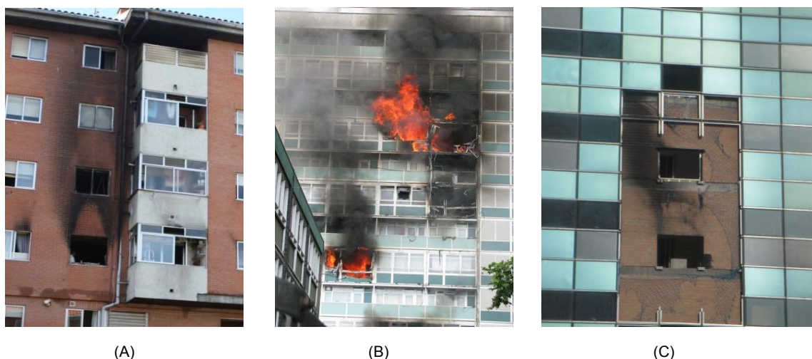
Fig. 2.19 (A) Incendio en un edificio residencial con fachada convencional de ladrillo, Barcelona. (B) Incendio en un edificio residencial con fachada ligera, Camberwell, Londres. (C) Incendio en un edificio administrativo con fachada ligera y trasdosado de ladrillo, Barcelona. Fotos: (A, B) internet, (C) P. Giraldo, 2010
