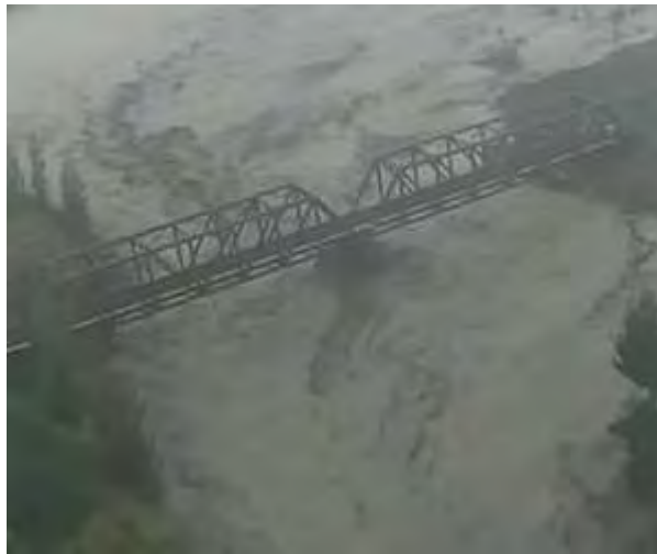
Figura 2. 4. Colapso del puente sobre Tangiwai [ www.search.tvnz.co.nz ]
