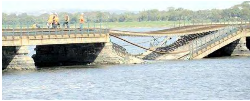
Figura 2. 9. Colapso del Puente sobre Broadmeadow.
