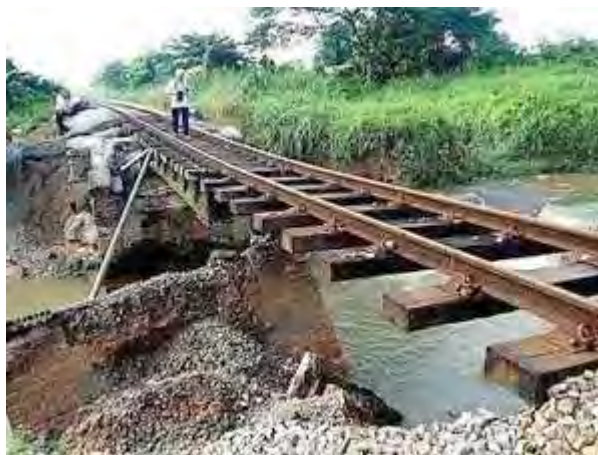
Figura 2. 5. Colapso puente cerca de Kulai. [ www.thestar.com.my ]
