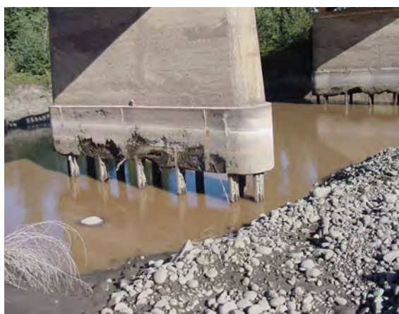
Figura 2. 23. Daño en pilas centrales y laterales.
