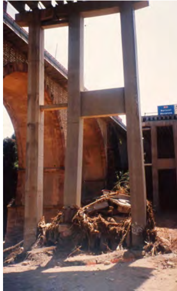
Figura 2. 6. Colapso puente Magarola.
