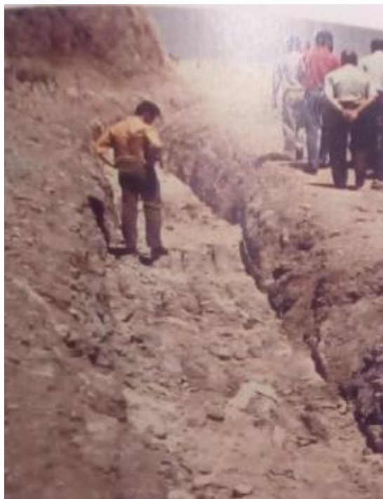
Figura 3. Canal de la Nía. Foto extraída de la Memoria del Proyecto de defensa contra las inundaciones de Aspe (Alicante) 1990.
