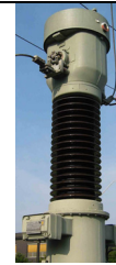
Figure 5 : Exemple de Combiné de mesure haute tension (ces équipements intègrent un transformateur HTB/BT)
