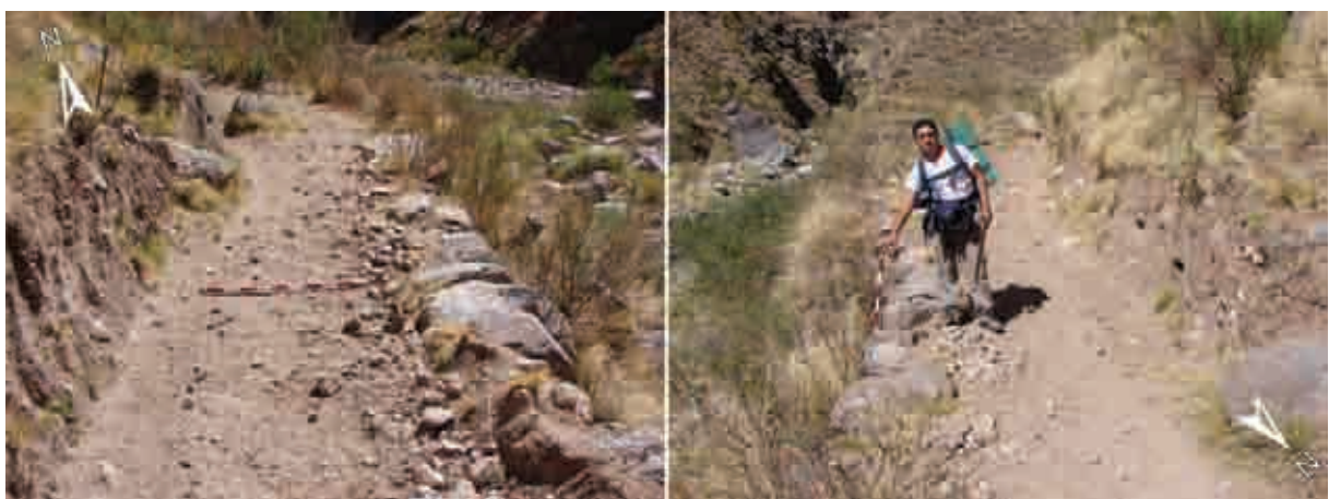
Figura VI.161. Camino con talud y excavación con un ancho de 1,60 m. Imagen tomada en las coordenadas 27^{\circ} 32' 51.09'' S; 67^{\circ} 12' 12.71'' O. Altura: 2497 msnm. Fotografía del autor.
