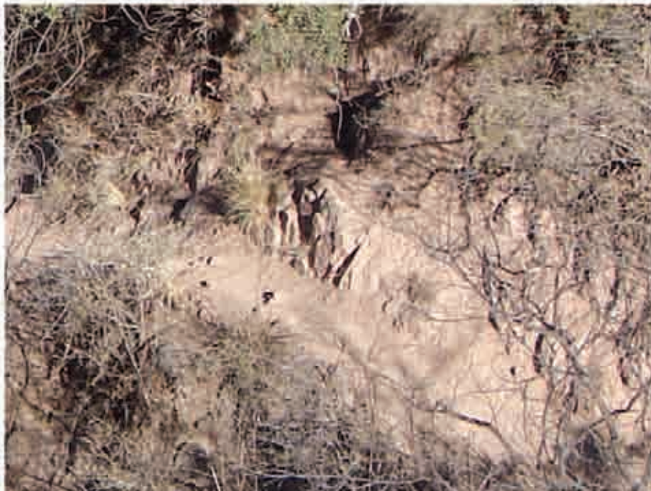
Figura V.45. Vista parcial y detalle del segmento de camino con talud y excavación dentro de la ladera correspondiente a la Figura V.33. Arriba: agentes naturales (e.g. procesos de remoción en masa) que afectan al camino. Fotografía del autor.
