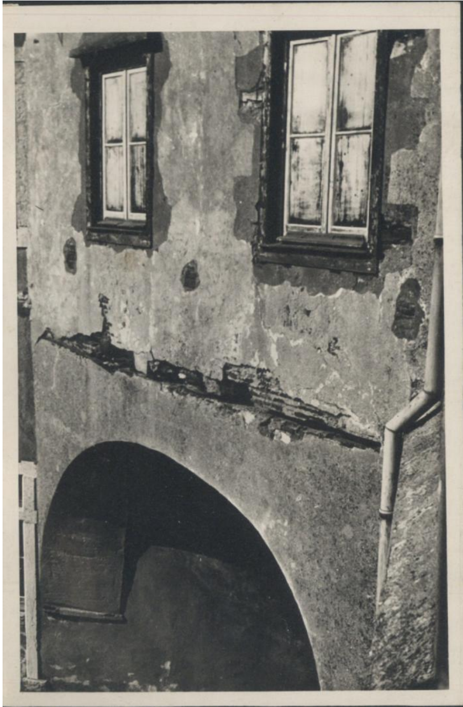
FIG. 1.- Mau estado de conservação do edifício de São Francisco. Biblioteca Nacional de Lisboa instalada no antigo Convento de S. Francisco junto ao Chiado - Lisboa [Visual gráfico]: vistas locais e estado de conservação dos livros em 1949 [1949]. - 1 álbum (56 fotografias) : p&b ; 19x14 cm; cota: ea-289-p © BNP.
