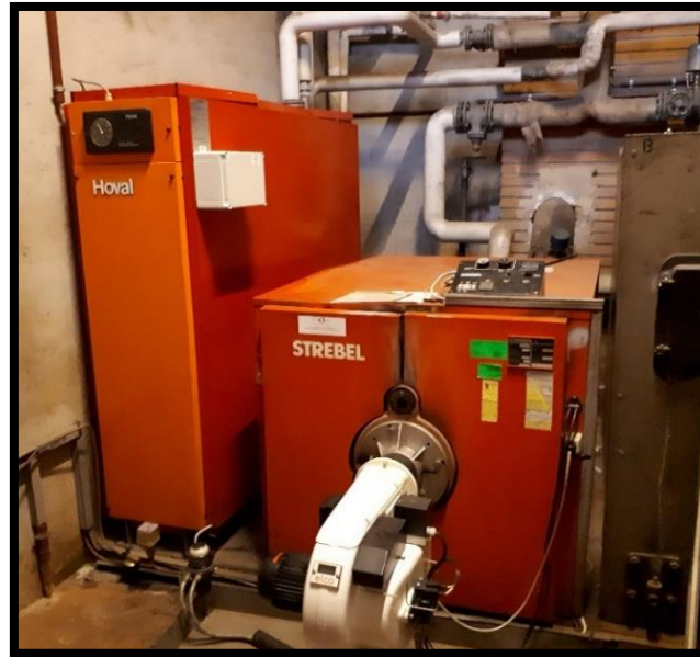
Image 3 : Chaudière à mazout - bâtiments C et D
