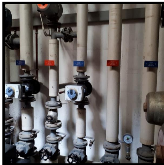
Image 4 : Conduites d'eau chaude - bât. A, B et D
