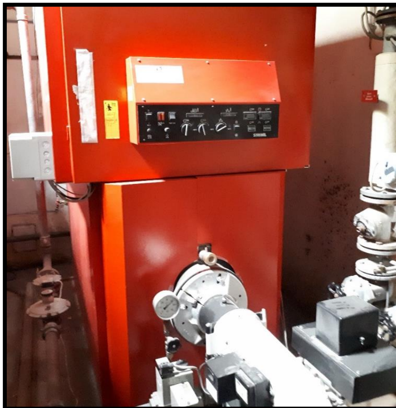
Image 2 : Chaudière à gaz - bât. A, B et D
