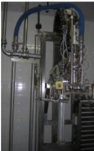
Fig. 6. Dosadora de tambores, em sala fechada.
