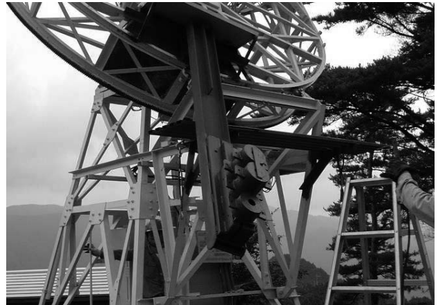
図2 8 m電波望遠鏡ウェイト部分(2008年7月撮影) サビ止め塗料の部分が、新しくなった部分。この後、上から白い塗料を塗る。
