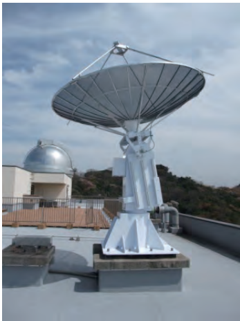
図2 新3mアンテナ (和歌山大学教育学部棟屋上)
