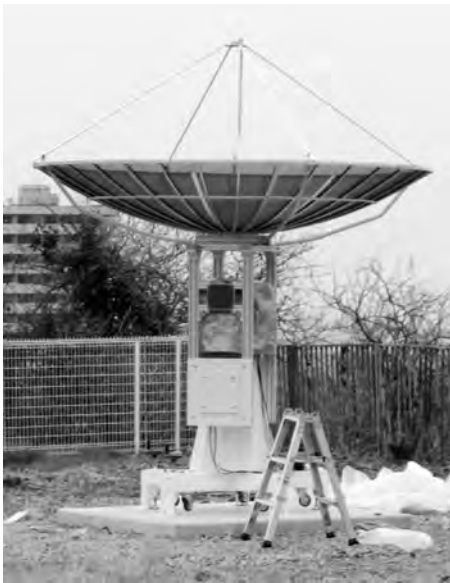
図2 和歌山大学3mアンテナ
