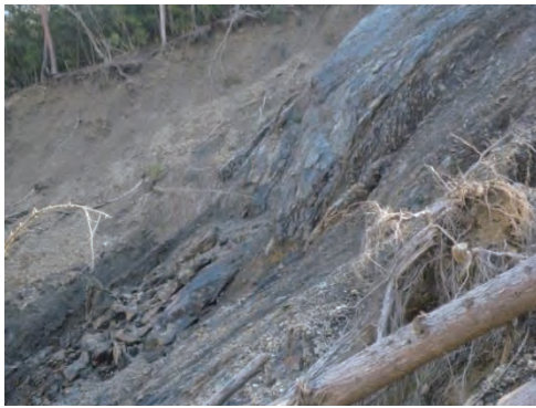
写真-1 スラストの破碎帯 (田辺市本宮町奥番. 2013年2月3日撮影)
