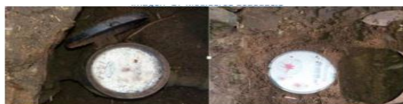
Ilustración 27 Medidores. Fuente: mantenimiento y servicios generales CORPONOR
