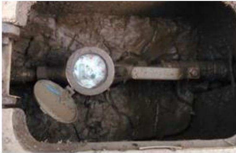
Ilustración 17 Fuente: Mantenimiento y servicios generales.
