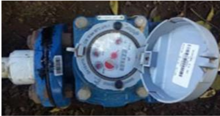
Ilustración 18 Fuente: Mantenimiento y servicios generales
