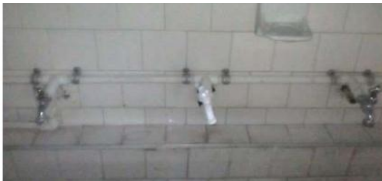
Ilustración 33 lavamanos. Fuente: oficina Ocaña
