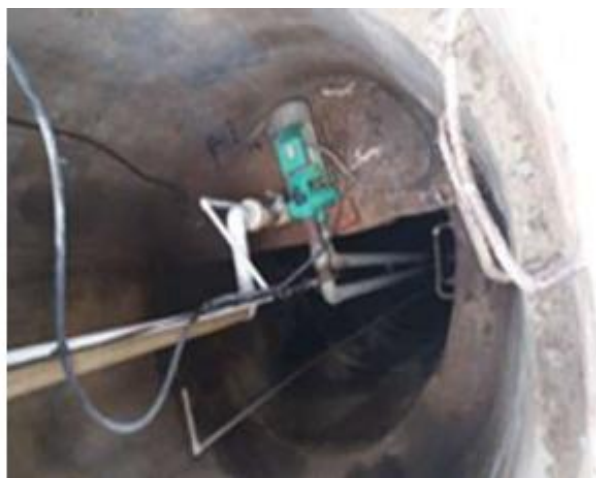
Ilustración 21 Pozo subterráneo. Fuente: Mantenimiento y servicios generales CORPONOR
