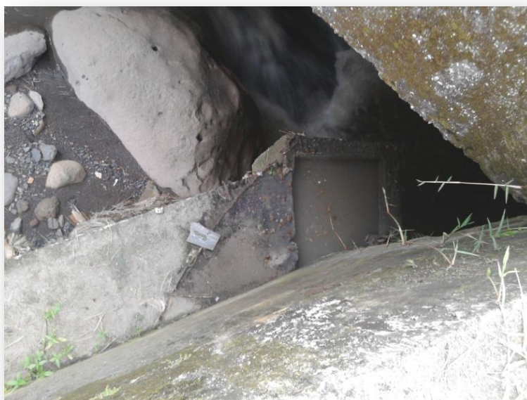
Figura N° 7: Problemas en el Alcantarillado
