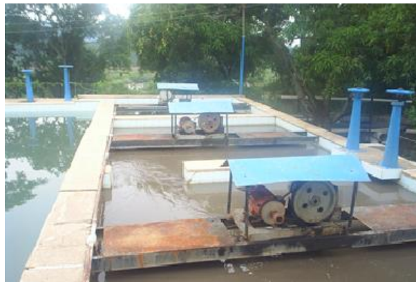
Fotografía 57. Planta de tratamiento de agua potable (PTAP) Tocaima
