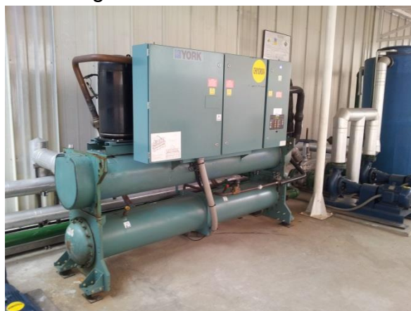
Imagen 23. Chiller YORK 33TR
