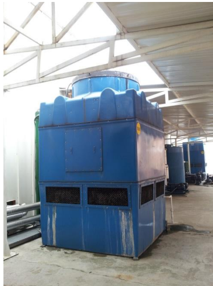
Imagen 22. Torre de enfriamiento AXINA SABAN
