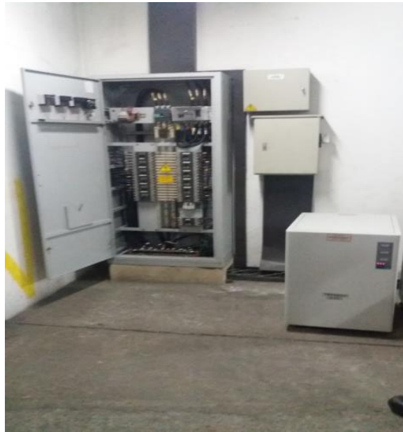
Imagen 11. Equipos Subestación Eléctrica.
