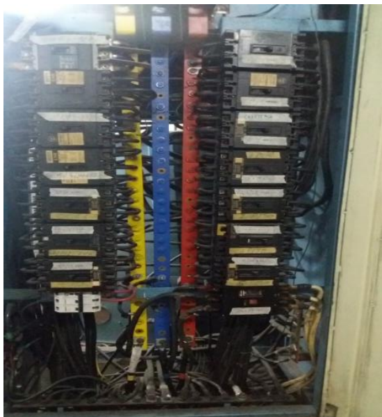
Imagen 10. Subestación Eléctrica - Primer Piso.
