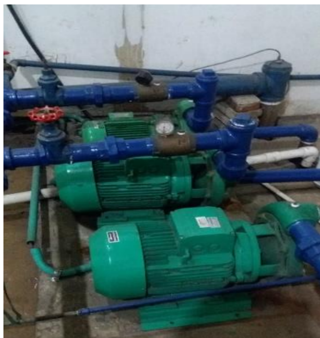
Imagen 3. Cuarto de Bombas - Primer Piso.
