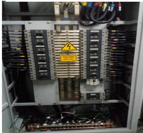
Imagen 12. Tablero Regulador de Tensión.
