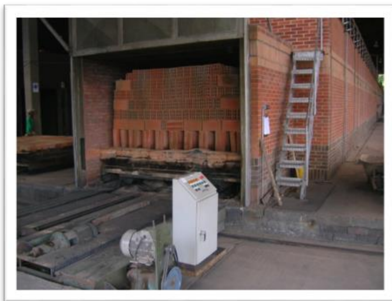
Figura 39, Horno de Túnel en Ladrillera San Cristóbal, Medellín - Colombia
