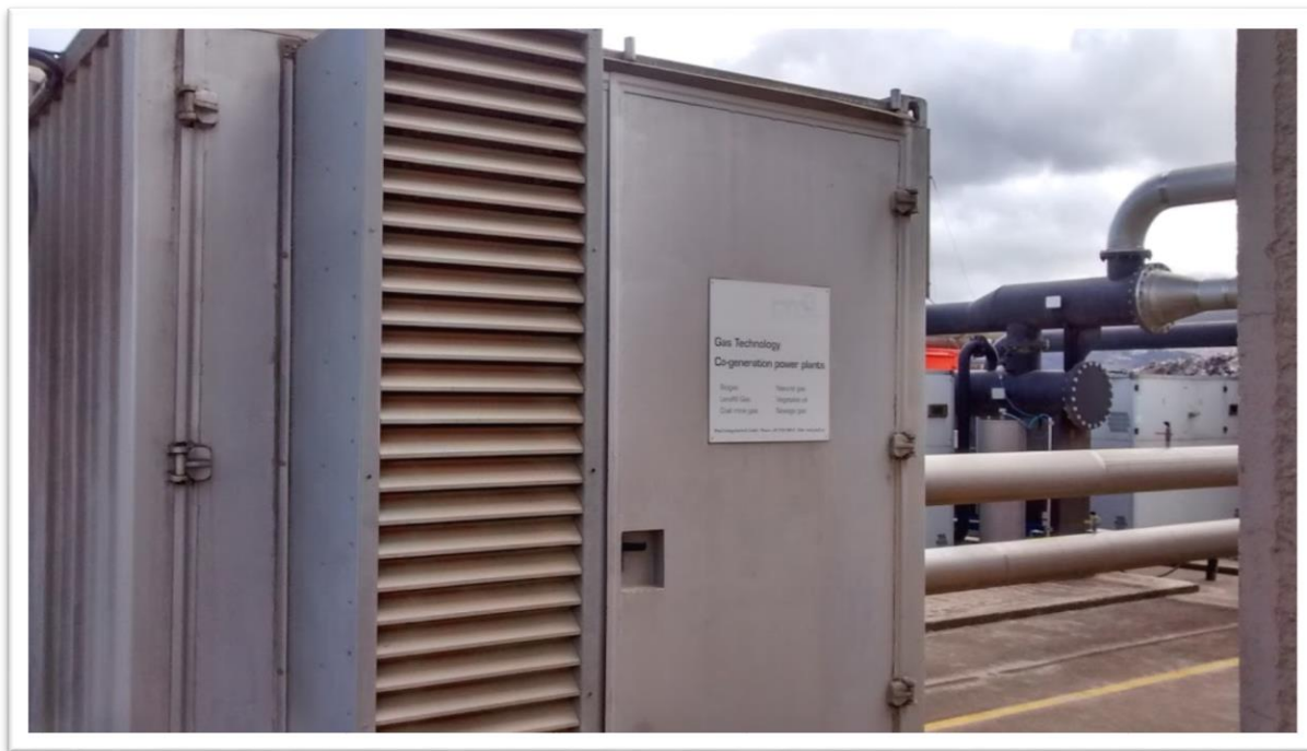
Figura 43. Planta de cogeneración eléctrica de Biogás en Relleno Sanitario Doña Juana
