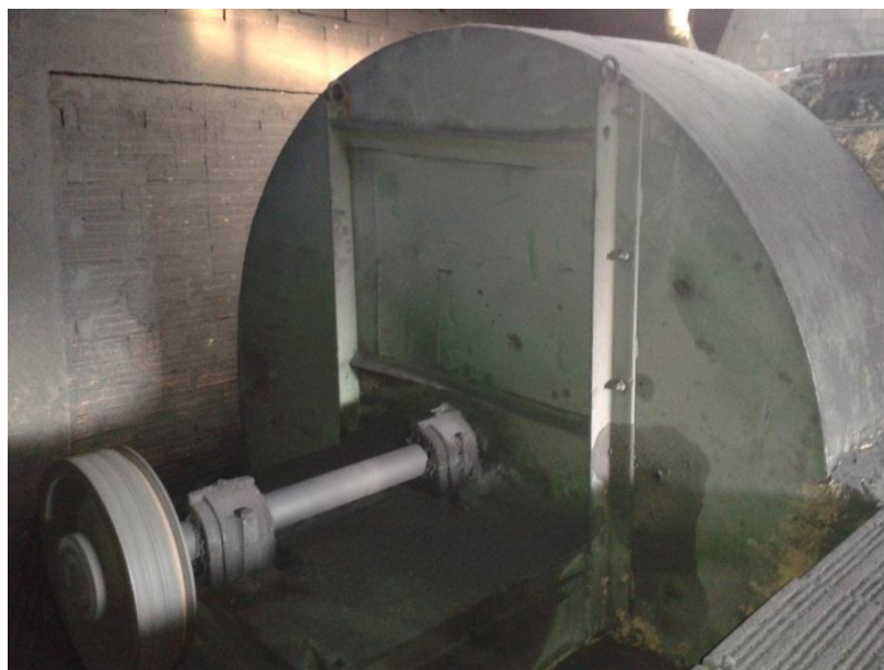
Figura 27. Ventilador de Succión en horno Hoffman semi continuo en Ladrillera Los Cristales
