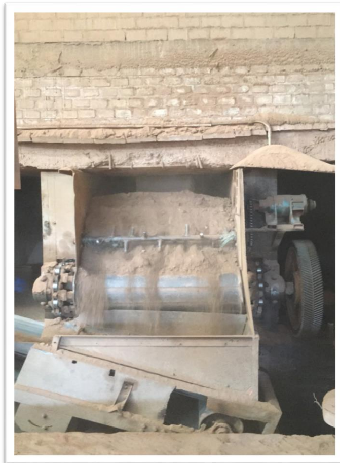
Figura 16. Cajón Alimentador en Ladrillera Los Cristales
