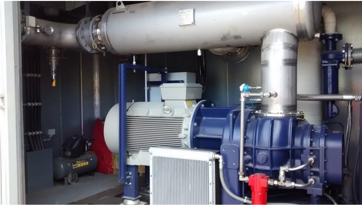
Figura 44. Compresor para la distribución de Biogás del relleno Sanitario Doña Juana
