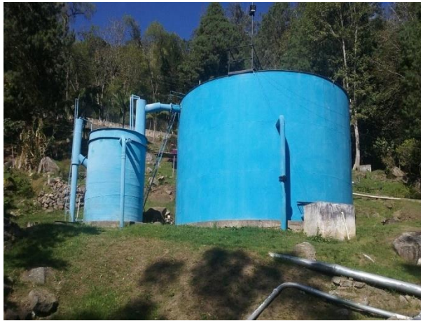
FOTO 3 Tanque de Agua
