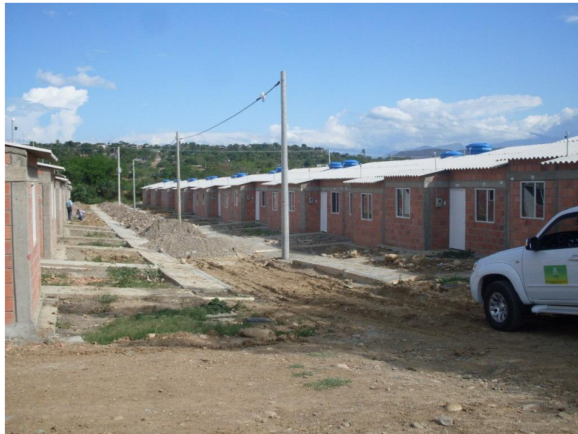
Fotos 19 y 20: En la obra Ciudadela El Progreso que desarrolla la Constructora Odicco – Metrovivienda
